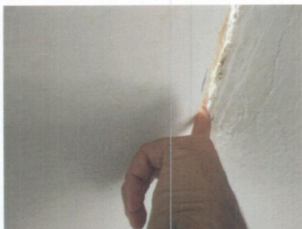
Figura 18 - DETALHE DA RACHADURA ATRAVESSANDO TODA ALVENARIA - SEM AMARRAÇÃO COM A EDIFICAÇÃO EXISTENTE
