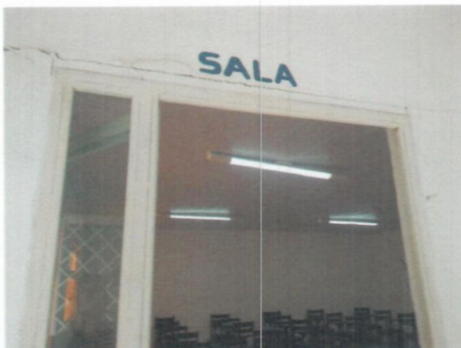
Figura 12 - RACHADURA NA ALV. SOBRE AS PORTAS
