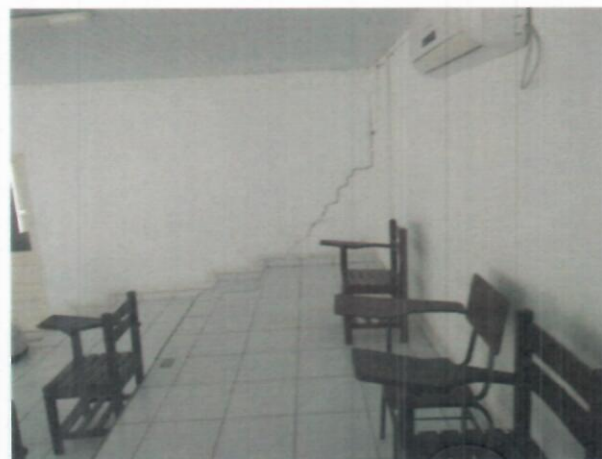
Figura 19 - RACHADURA NA PAREDE
