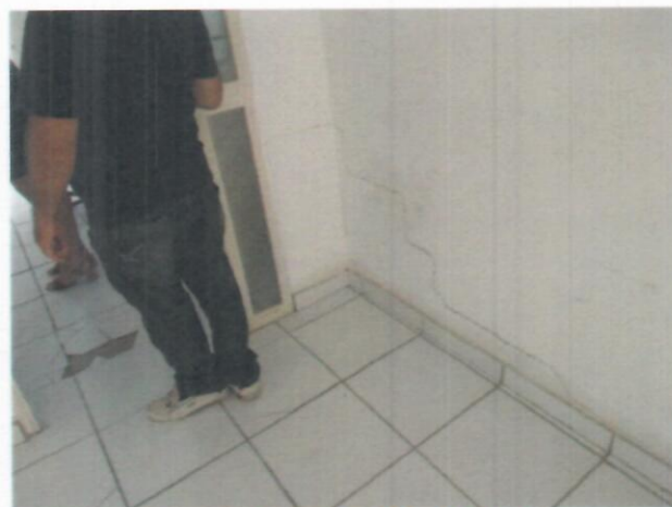
Figura 15 - RACHADURAS NAS PAREDES
