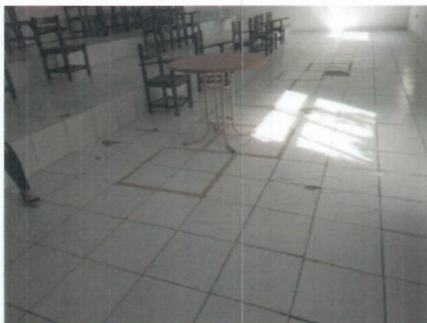
Figura 16 - PISO CERÂMICO DANIFICADO
