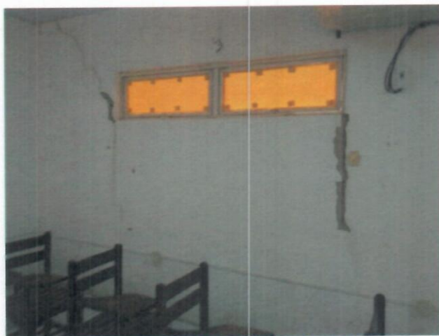
Figura 14 - RACHADURAS NAS PAREDES
