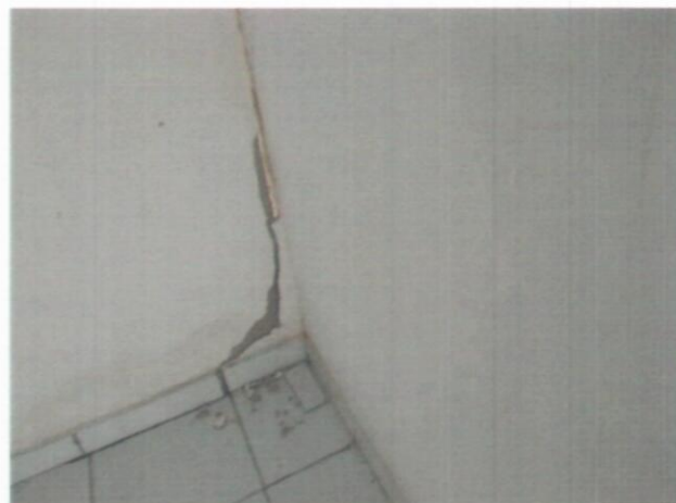
Figura 17 – RACHADURAS NA PAREDE
